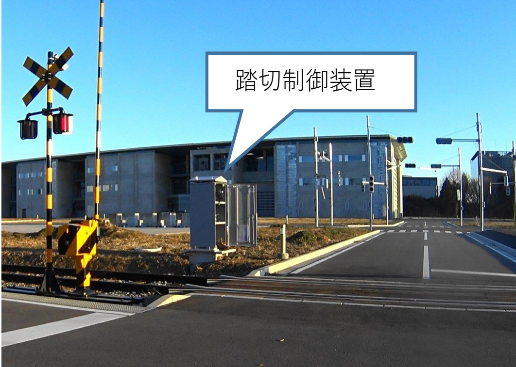
踏切制御装置
